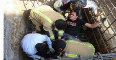
▲ سقوط کارگر آرماتوربند از ارتفاع و شکستگی پا - فقدان وسایل حفاظتی
