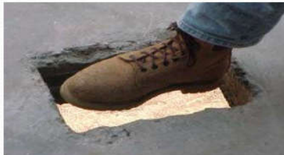
▲ حفره حفاظت نشده در کف و امکان بروز حادثه برای کارگران
