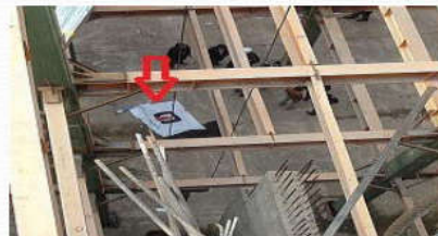
▲ سقوط و مرگ جوشکار از بالای اسکلت فلزی - فقدان وسایل حفاظتی
