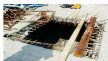
▲ دهانه بازشو حفاظت نشده و ریشه های بیرون زده آرماتور
