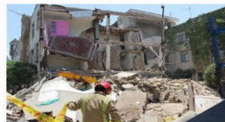
▲ ریزش ساختمان مجاور ناحیه گودبرداری
