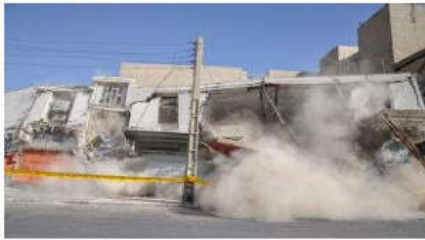
▲ ساختمان در حال ریزش بدلیل گودبرداری غیر اصولی در مجاورت آن
