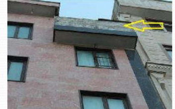
▲ سقوط سنگ نما در اثر اجرای نامناسب بهنگام طوفان
