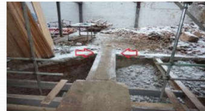
▲ راهروی دسترسی نا ایمن و حفاظت نشده ، احتمال سقوط کارگران
