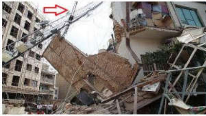
▲ سقوط دکل مخابراتی بر روی ساختمان مجاور
