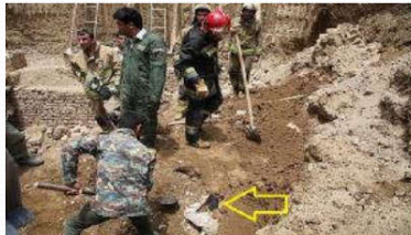
▲ ریزش دیواره گود و دفن کارگر در زیر آوار
