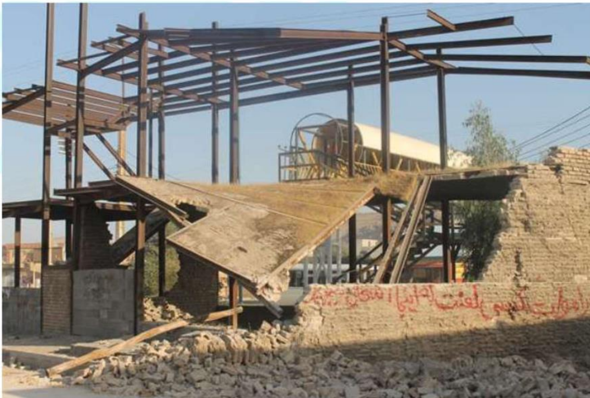
فروریزش بخشی از سقف سازه فولادی در حال اجرا
