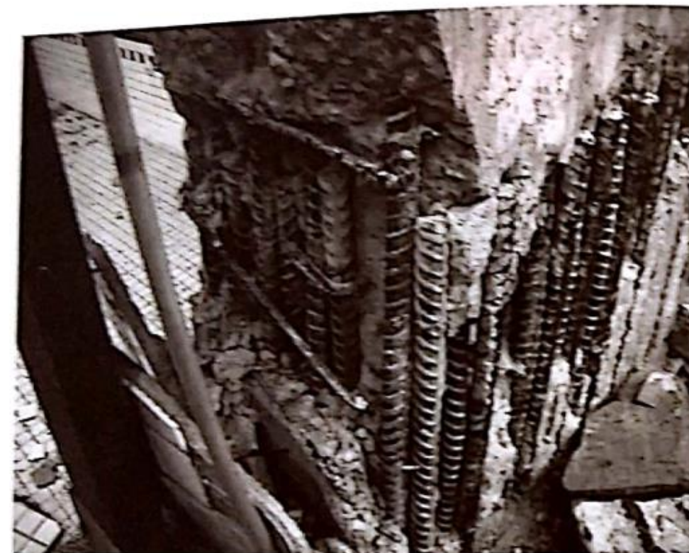
عدم تأمین حداقل طول همپوشانی در حلقه پیوستگی و شکست ستون در زلزله ۱۹۹۹ چی چی، تایوان
