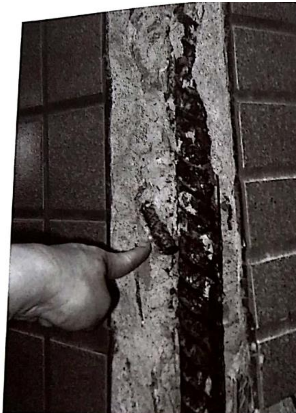
عدم رعایت پوشش بتن ستون - زلزله ۱۹۹۹ چی چی، تایوان
