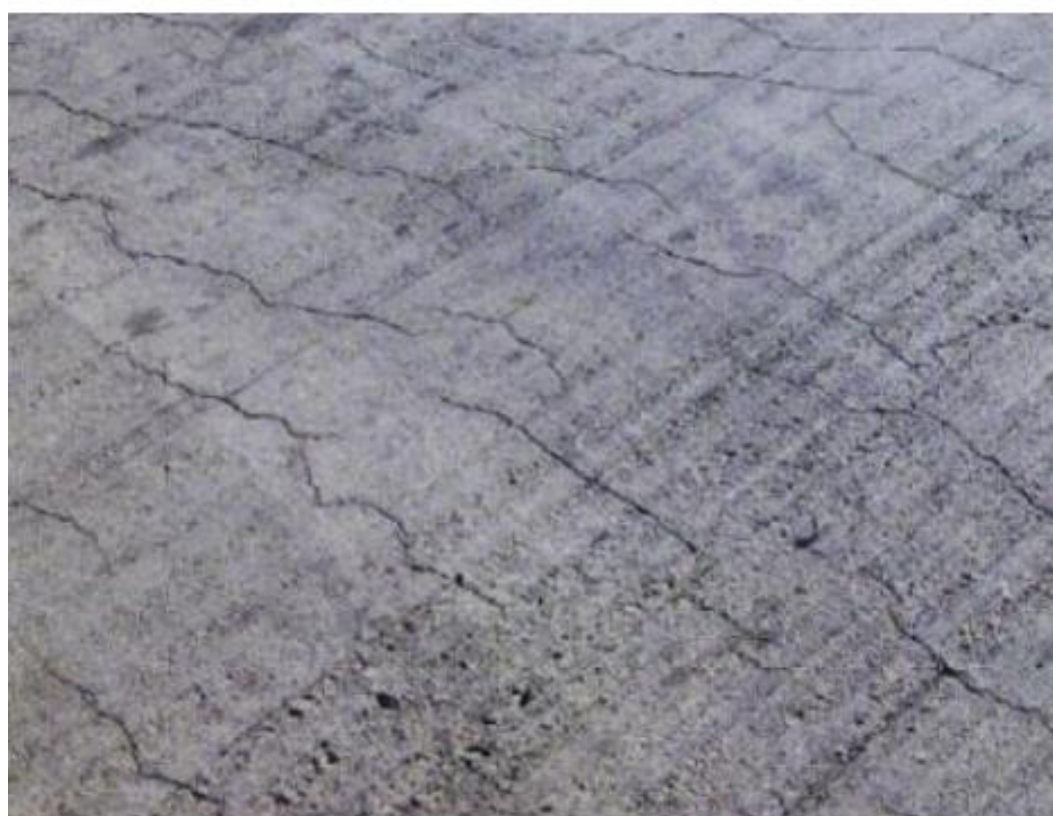
ترک ناشی از جمع شدگی خمیری (Plastic Shrinkage Cracking)
