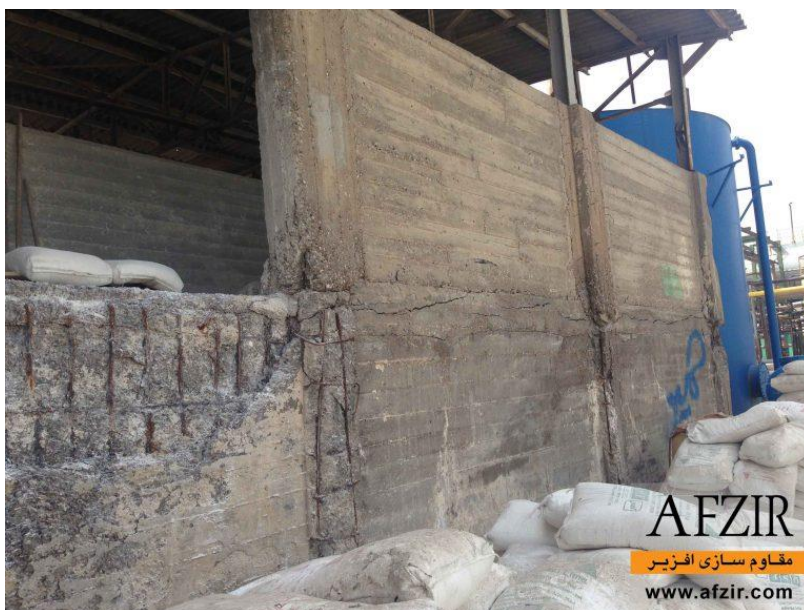
ترک خوردن بتن در دیوار
