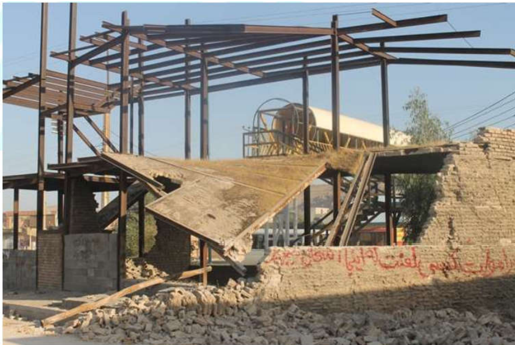
شکل ۵-۵ فروریزش بخشی از سقف سازه فولادی در حال اجرا
